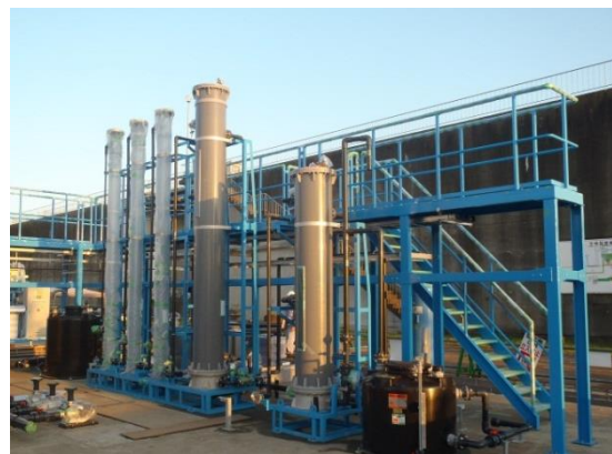
図 2.6 実証実験設備の状況
