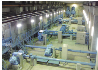
そうすい 送水ポンプ
