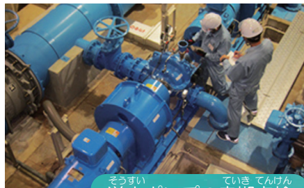
そうすい ていき てんけん 送水ポンプの定期点検
