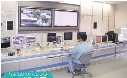
ちゅうおうかんしつ 中央監視室
