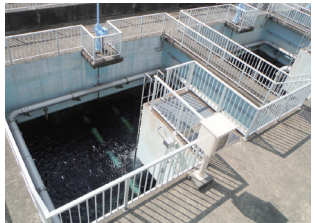
きゅうそくろかち 急速ろ過池
